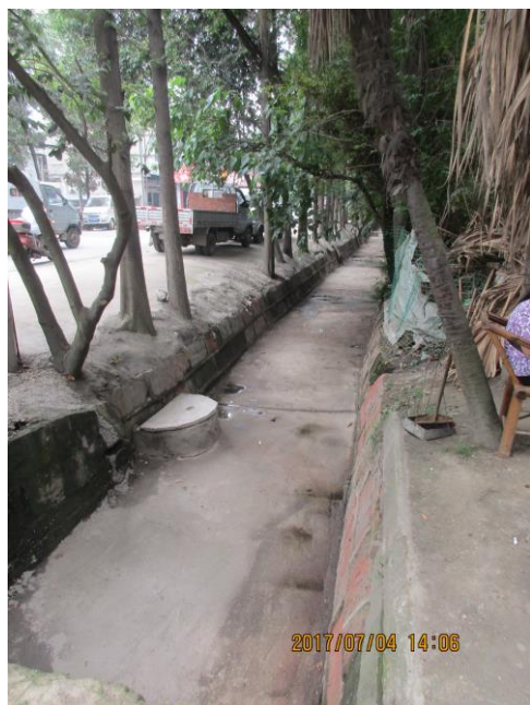
硬化后，毫无生命力 武侯区苏坡六斗渠（2017.7.4）
