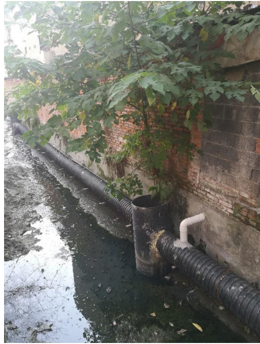
鸡公堰临时截污管道滴漏 武侯区鸡公堰（2017.7.11）
