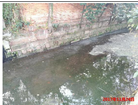
部分河段变成了排污渠 龙泉驿区秀水河（2017.11.24）
