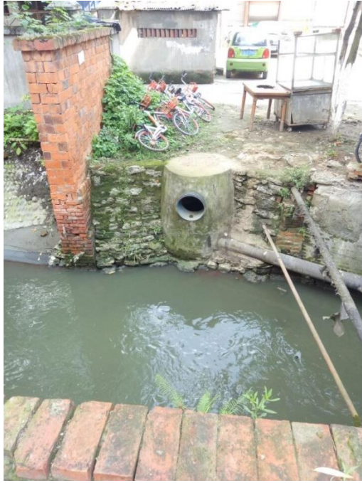
雷建昌站宿舍处管道破损，污水直排 金牛区凤凰河（2017.8）
