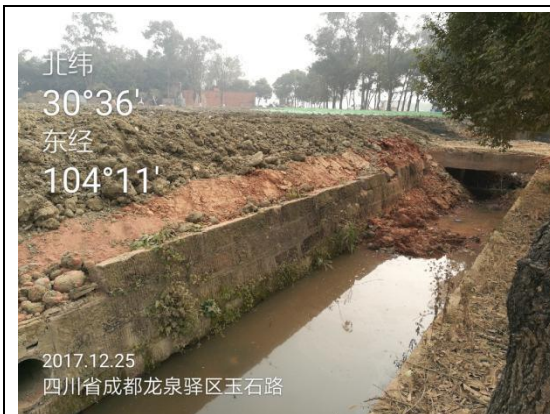
施工未考虑河流现状 龙泉驿区西洪河溪（2017.12.25）
